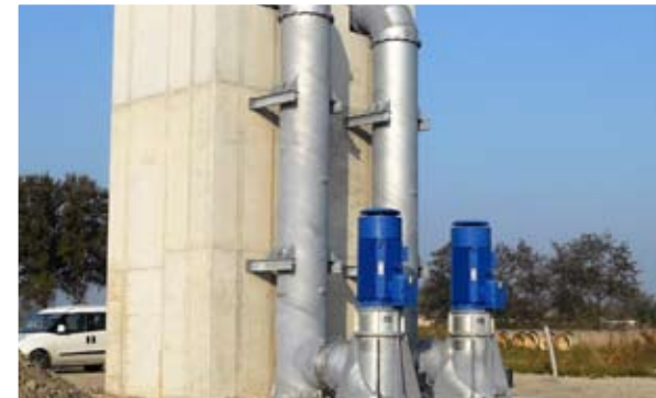
Consorzio di Bonifica Dugali - Naviglio - Adda Serio Impianto di sollevamento Pieve S. Giacomo Importo lavori € 251.475
