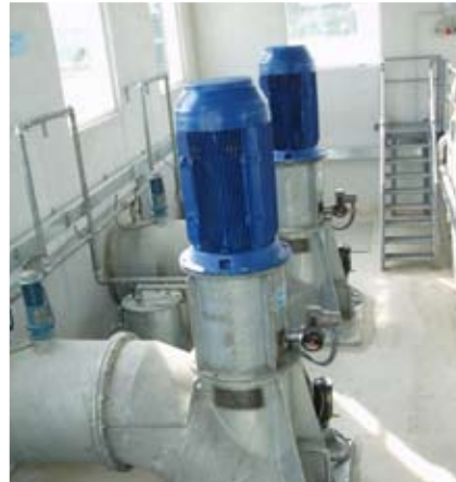
Consorzio di Bonifica Valli di Vecchio Reno Impianto idrovoro San Nicolò Importo lavori € 513.019
