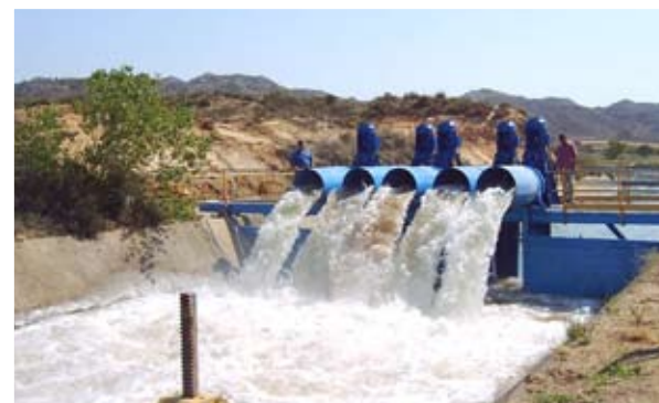
Bombas Ercole Marelli - Spagna Fornitura di elettropompe (siccity 2005) Importo lavori € 602.000
