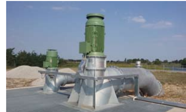
Consorzio di Bonifica Adige Euganeo Impianto idrovoro Pascoletti Importo lavori € 65.024
