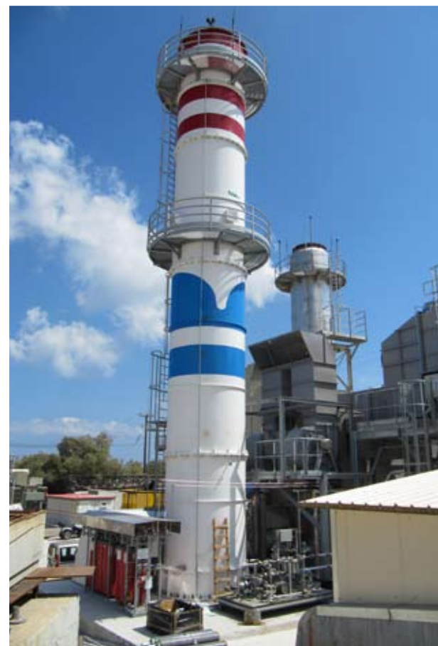
Public Power Corporation S.A. Camino per turbina a gas Santorini - Grecia Importo lavori € 225.131
