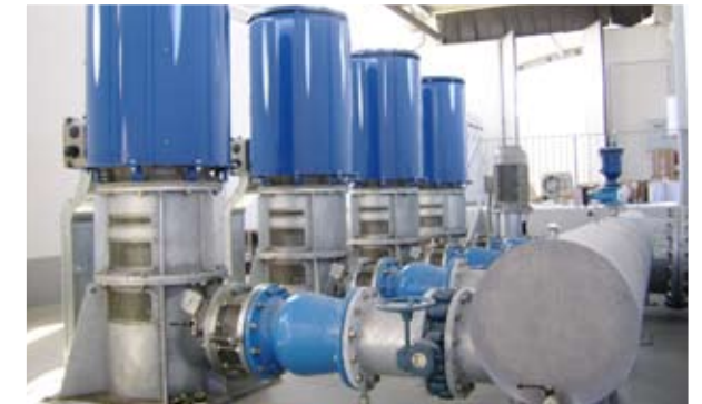
Consorzio di Bonifica della Romagna Occidentale - Cons. Bon. II° Grado per il Canale Emiliano Romagnolo Impianti di pompaggio Mordano-Bubano e Passo Cavallo Importo lavori € 675.000
