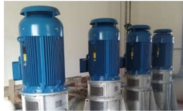
Consorzio di Bonifica del Nord Sardegna Impianto idrovoro Valledoria Importo lavori € 165.200
