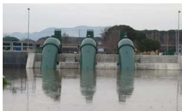
Consorzio di Bonifica Versilia Massaciuccoli Impianto della Bufalina sul canale napoleonico Importo lavori € 689.774
