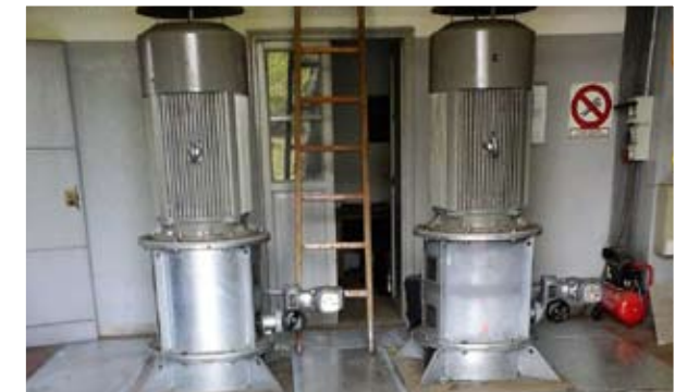
Consorzio di Bonifica Tevere e Agro Romano Impianto idrovoro Isola Sacra Importo lavori € 187.050
