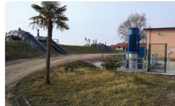
Consorzio di Bonifica Pianura Friulana Impianti idrovori Vittoria e Colomba Importo lavori € 798.401
