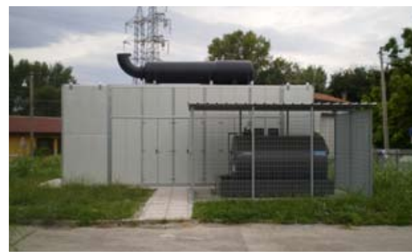
VERITAS S.p.A. Impianto idrovoro Cà Emiliani Importo lavori € 1.476.156
