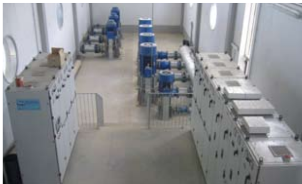
Consorzio di Bonifica della Romagna Occidentale - Cons. Bon. II° Grado per il Canale Emiliano Romagnolo Impianti di pompaggio S. Severo, Cassanigo e S. Silvestro Importo lavori € 1.540.000
