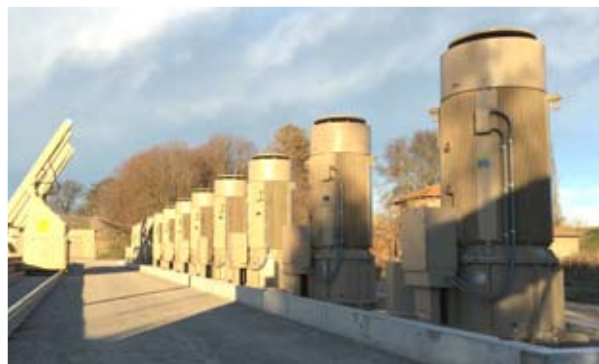
Consorzio di Bonifica dell'Emilia Centrale Impianto idrovoro Mondine Importo lavori € 4.718.662
