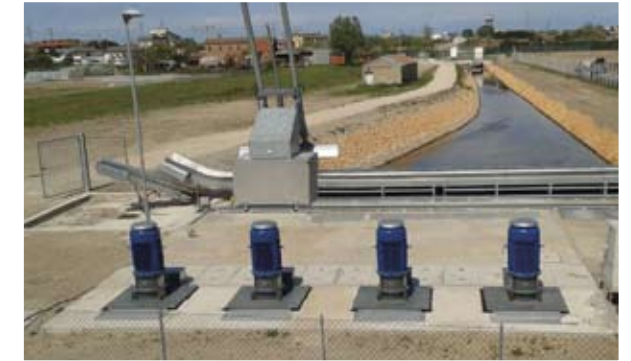
Consorzio di Bonifica Bacchiglione Impianto idrovoro Brondolo Importo lavori € 432.000
