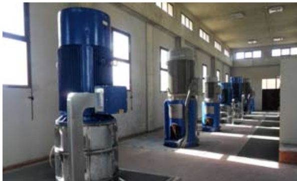
Consorzio di Bonifica Ombrone Pistoiese Bisenzio Impianto idrovoro Castelletti Importo lavori € 651.263
