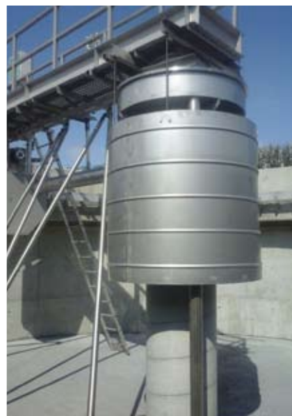
Livenza Tagliamento Acque S.p.A. Ristrutturazione depuratore S. Stino di Livenza Importo lavori € 364.859
