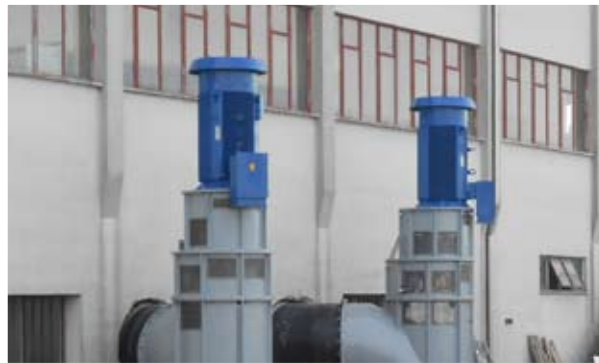
Consorzio di Bonifica Veneto Orientale Impianto idrovoro Valle Tagli Importo lavori € 700.340
