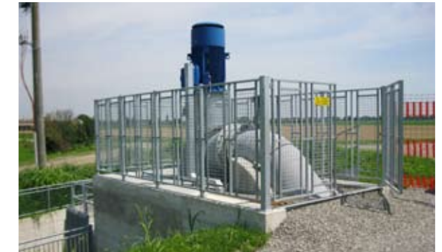
Consorzio della Bonifica Parmense Impianto idrovoro Cantonale Importo lavori € 204.207
