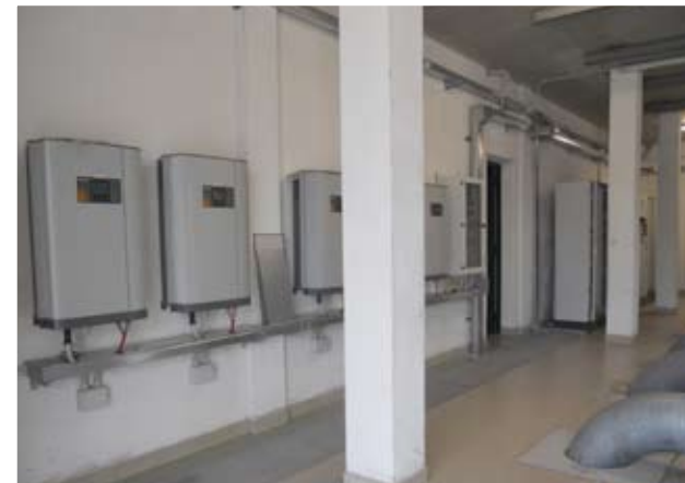
Consorzio di Bonifica Piave Impianto fotovoltaico Bolda Importo lavori € 315.000
