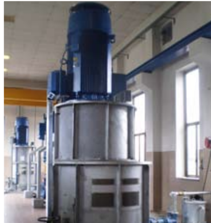
VERITAS S.p.A. Impianto idrovoro Cà Emiliani Importo lavori € 1.476.156
