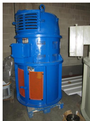
Pellizzari GAVF 1000/16 - 195 CV - 365 giri/min - 16 poli Idrovora Zuccarello, Consorzio di Bonifica Acque Risorgive
