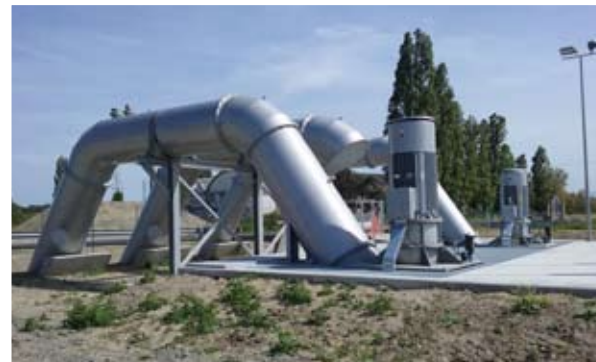
Consorzio di Bonifica della Romagna Tagliata pumping station Amount of work € 400.000
