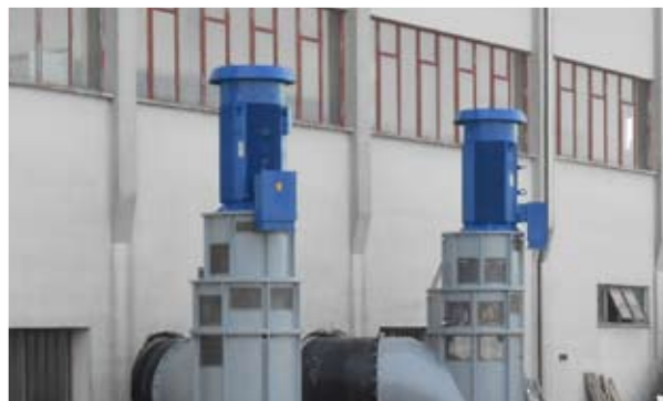
Consorzio di Bonifica Veneto Orientale Valle Tagli pumping station Amount of work € 700.340
