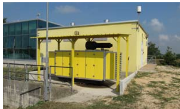
Consorzio di Bonifica Destra Piave Portesine pumping station Amount of work € 701.400
