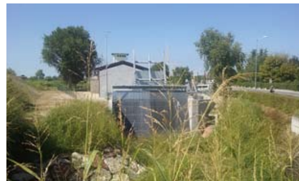
Consorzio di Bonifica Piave Fossa dei Negadi pumping station Amount of work € 783.584
