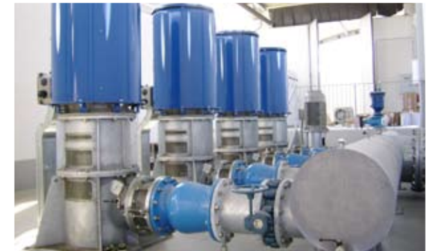
Consorzio di Bonifica della Romagna Occidentale - Cons. Bon. II° Grado per il Canale Emiliano Romagnolo Mordano-Bubano and Passo Cavallo pumping station Amount of work € 675.000
