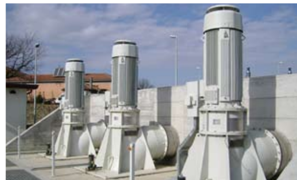
Consorzio di Bonifica Pianura di Ferrara S. Antonino pumping station Amount of work € 465.063
