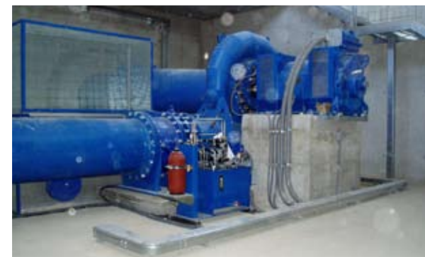
Consorzio di Bonifica Medio Astico Bacchiglione Cà Fusa hydroelectric station Amount of work € 497.800
