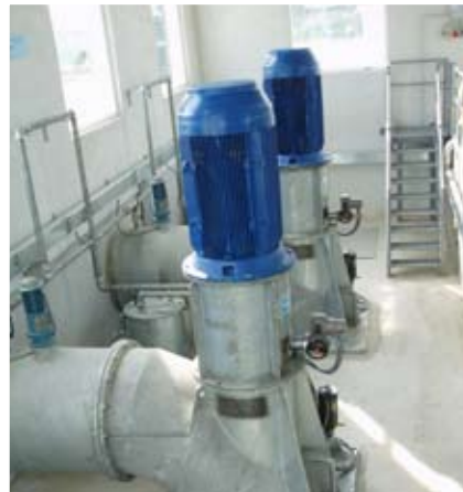
Consorzio di Bonifica Valli di Vecchio Reno San Nicolò pumping station Amount of work € 513.019
