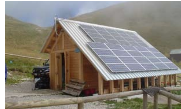
CAI - Club Alpino Italiano Dal Piaz photovoltaic system Amount of work € 60.088
