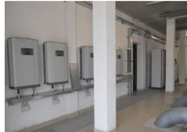
Consorzio di Bonifica Piave Bolda photovoltaic system Amount of work € 315.000
