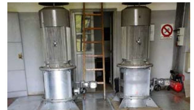
Consorzio di Bonifica Tevere e Agro Romano Isola Sacra pumping station Amount of work € 187.050
