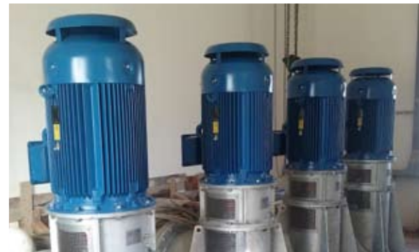
Consorzio di Bonifica del Nord Sardegna Valledoria pumping station Amount of work € 165.200
