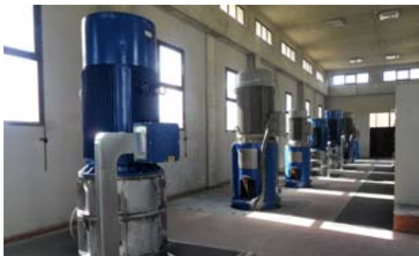
Consorzio di Bonifica Ombrone Pistoiese Bisenzio Castelletti pumping station Amount of work € 651.263
