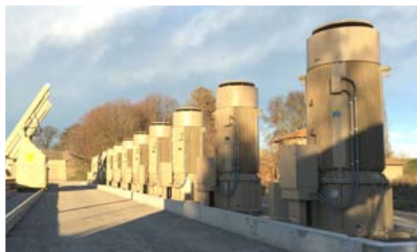
Consorzio di Bonifica dell'Emilia Centrale Mondine pumping station Amount of work € 4.718.662
