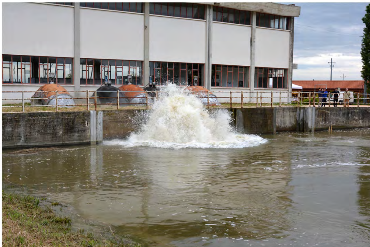
Avvio pompa P5
